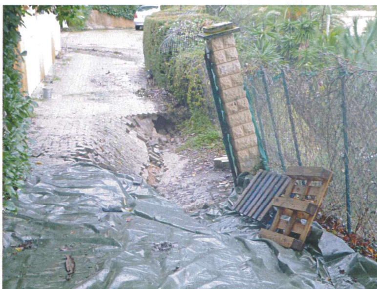
Commune de Sainte Agnès - Glissement de terrain
